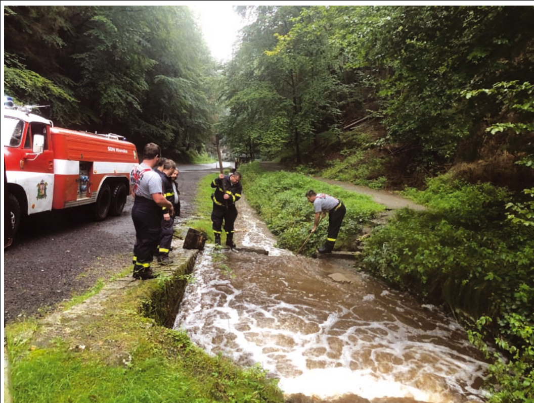
Poslední prázdninový den začal vydatnými dešti, které opět způsobily potíže s ucpaným korytem potoka Suchá Bělá u Klepáče a na parkovišti. Hasiči zde koryto vyčistili, uklidili vozovku a vyčistili silniční kanály.
